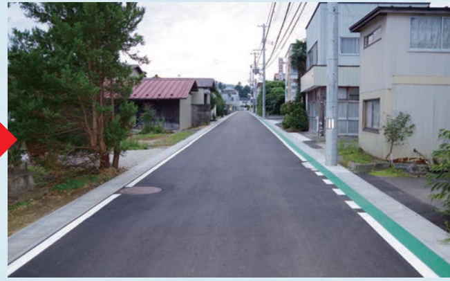
施工後 縁石がなくなり、電柱も移動しました。左右の側溝も入れ替えられ、広々でとてもきれいです。
