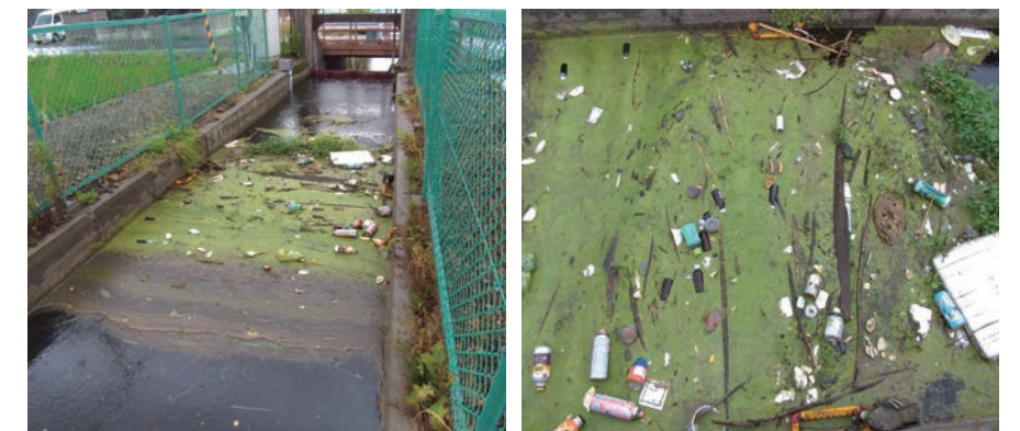
▲水路に詰まったごみ
