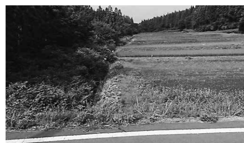
▲土側溝のため貴重な水が
